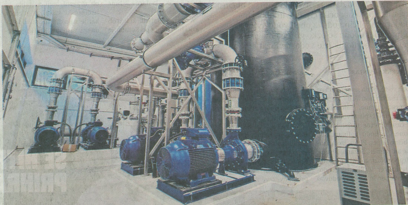
V Ilirski Bistrici so v sklopu gradnje povezovalnega vodovoda posodobili tudi vodarno z novim sistemom ultrafiltracije.
